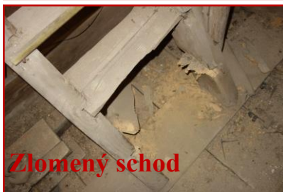
Původní havarijný stav
